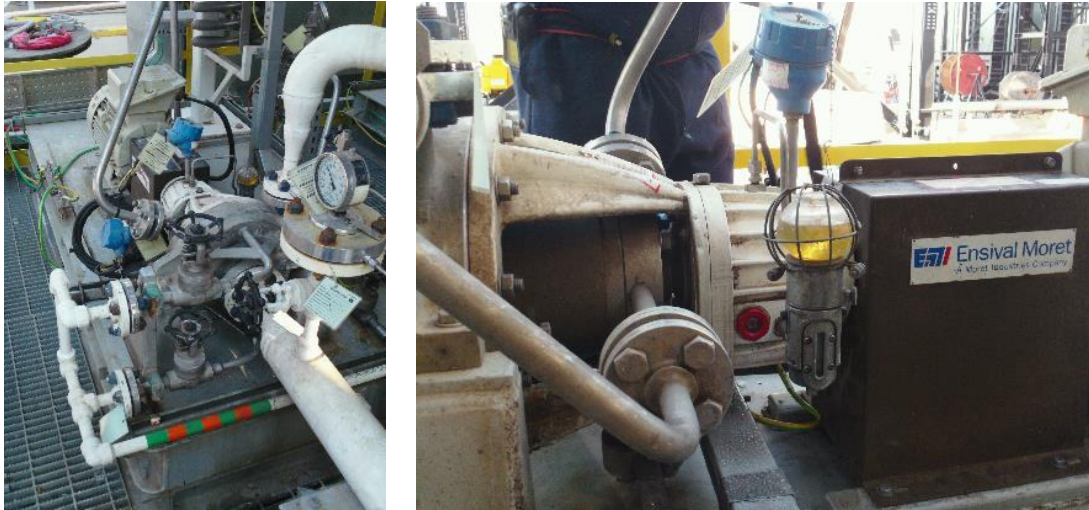
FIGURA 1: BOMBA SR-P-1313 A
