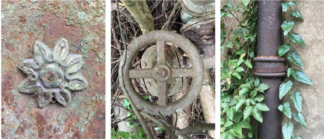
Ornamento en herrería e instalaciones en degradación. (Isla Martín García)
