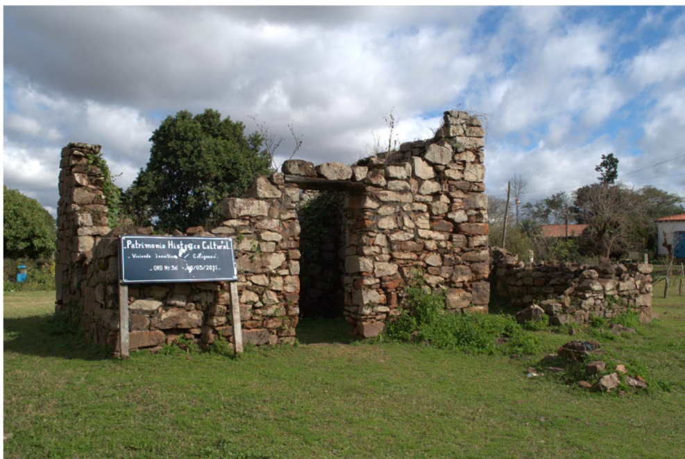
Ilustración 52: Vivienda jesuítica o "cotiguazú" (aposento grande en guaraní). Patrimonio histórico cultural por Ordenanza N°36/2011 del Municipio de Yapeyú. Fotografía tomada por el autor en julio de 2016. Ver ubicación en Ilustración 48.
