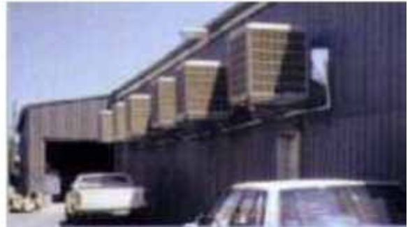
Ductos, aislación y rejillas
