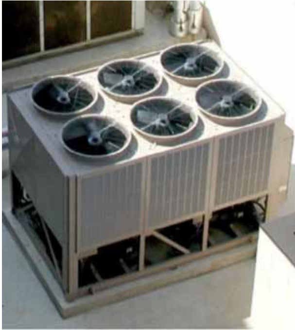
Unidades Enfriadoras, Chillers Unidad Tratamiento de Aire UTA
