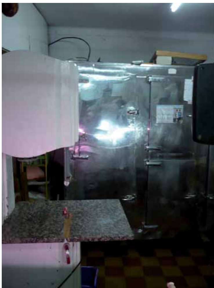
Figura 25: Aspecto externo de una de las cámaras frigoríficas.
