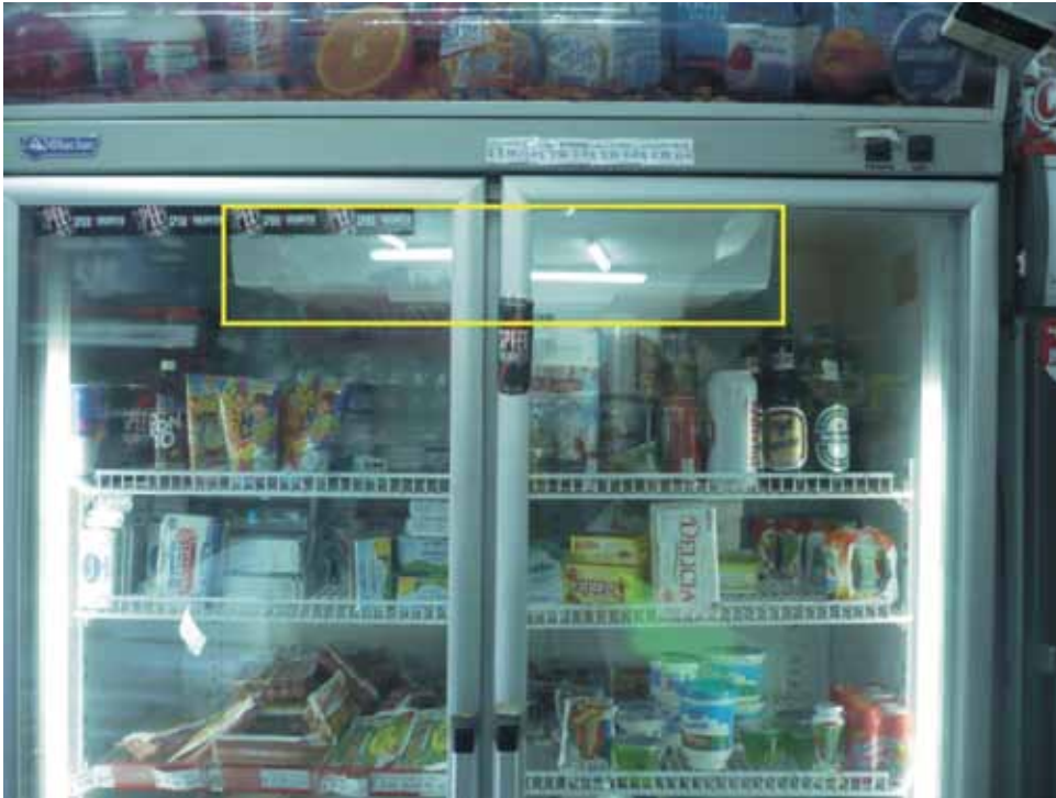
Figura 20: Salida de aire frío de las heladeras tipo 4.
