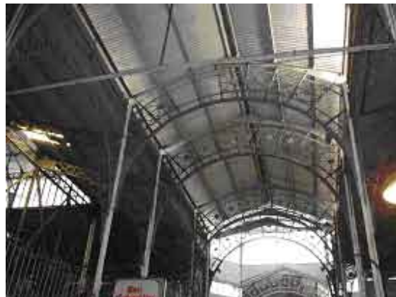
Fig. 24. Mercado de San Pedro Telmo, particular de la cubierta metálica, Buenos Aires, Argentina. (Autora)
