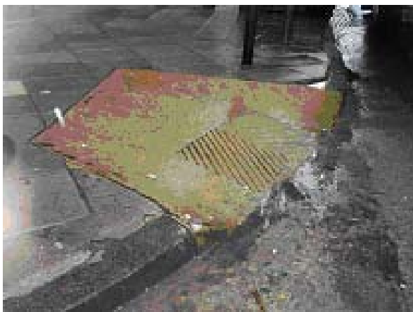
Fig. 7. Rampa oficial con acumulación de agua. L. M. Campos y Virrey del Pino. (Fuente: Vilán)
